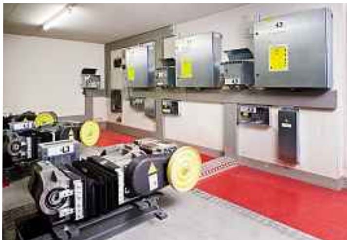
Triplex elevatoranlæg som drives af DR SGB 142, forbundet med en CO MX elevatorstyring
