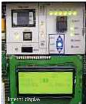
Elevatorstyring og frekvensomformer
