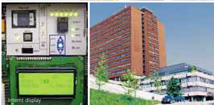
Elevatorstyring og frekvensomformer
